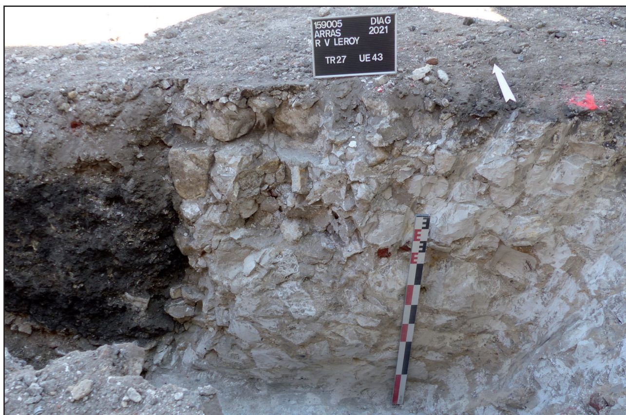
Fig. 36 : Arras, rue Victor Leroy, vue en coupe de la maçonnerie 43 et de son arrachage 48, cliché H. Agostini - DA, CD 62.
