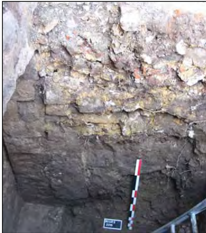
Fig. 12 : Bours, le Donjon, vue de la paroi nord du sondage. A droite, de bas en haut, la marche, le piédroit et le linteau. Au centre, le mur de bouchage en grès (démolition de l'escalier au XVIe siècle) et la fondation de l'escalier contemporain (cliché, Willot J.M., Centre départemental d'archéologie).
