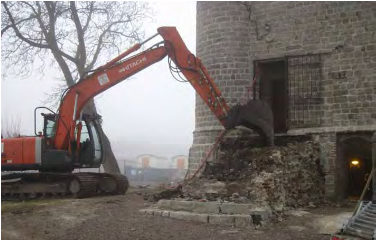
Fig. 9 : Bours, le Donjon, le démontage de l'escalier, le sondage, de 2 m de côté, a été réalisé au droit de la porte du niveau supérieur sur 2,50 m de profondeur (cliché, Willot J.M., Centre départemental d'archéologie).
