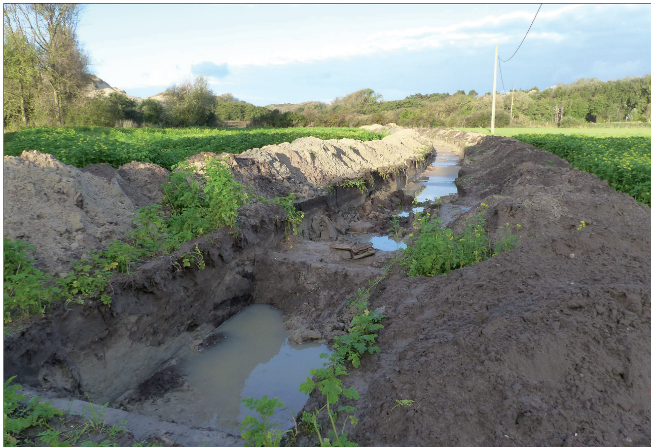
Fig. 13 : Groffliers, digue rétro littorale, Secteur Bois des Sapins, vue d'une tranchée de diagnostic immergée et aux parois effondrées, cliché O. Dewitte - DA, CD 62.
