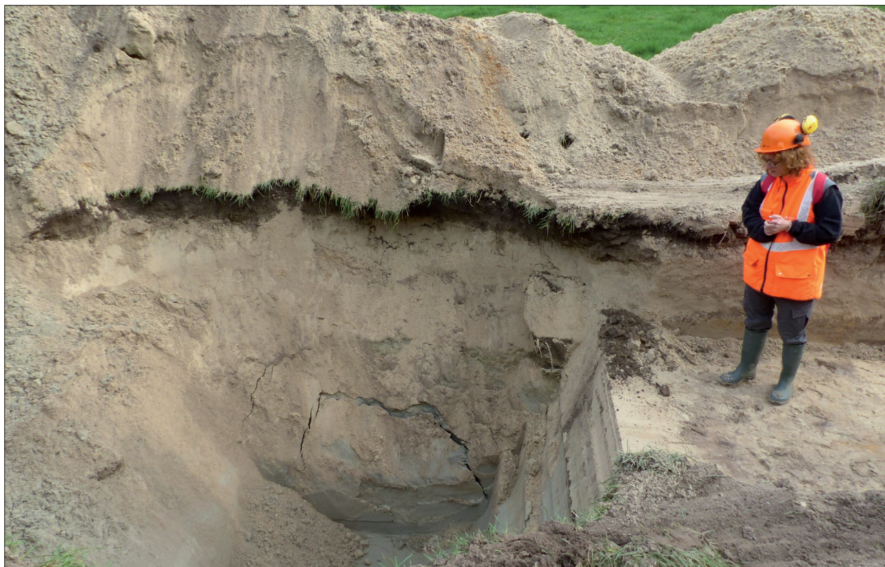
Fig. 12 : Groffliers, digue rétro littorale, Secteur Bois des Sapins, vue d'un sondage géologique prêt à s'effondrer, cliché O. Dewitte - DA, CD 62.
