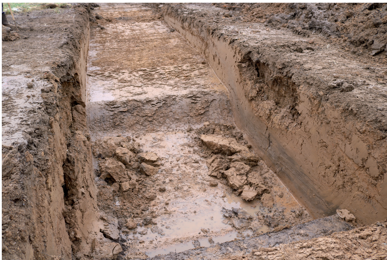
Fig. 17 : Hesdin, Centre Hospitalier, compacité faible des niveaux de remblai UE 5, cliché H. Agostini - DA, CD 62.
